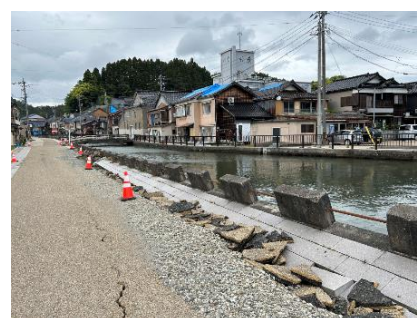
公共土木施設の被害の様子
