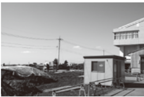
建設が進む能登高校アーチェリー場。競技を実際に見てもらえることで部員数の確保も期待される。
