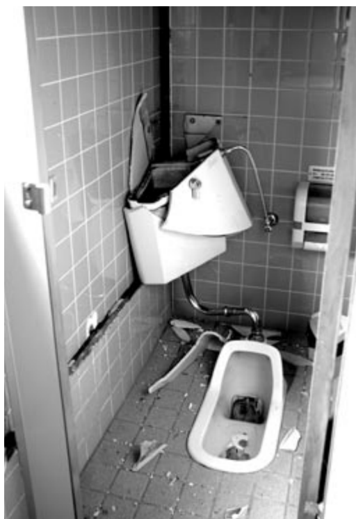
別館3階のトイレ。やなぎだ荘では別館3階の被害が大きかった
