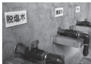
深層水取水施設の分水場。原水、濃縮水、脱塩水の3種類が持ち込み容器に分水される。
