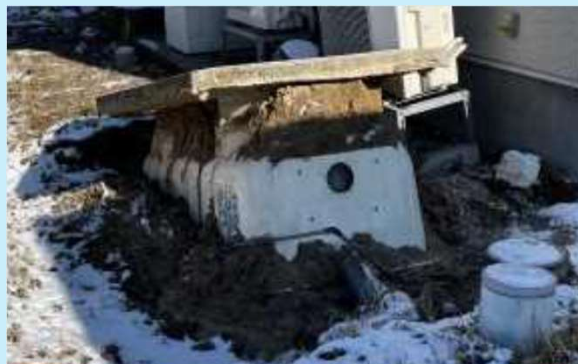
地震により浮き上がった浄化槽
