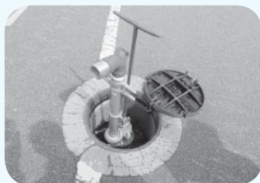
町道に設置されている消火栓
