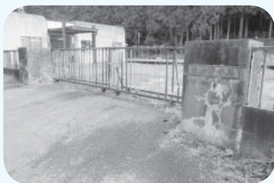
老朽化が著しい旧漆原浄水場の門扉
